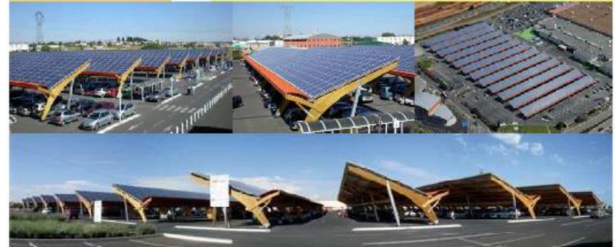
Ombrières sur parking du centre commercial E. Leclerc de Saint-Aunès près de Montpellier (34)
