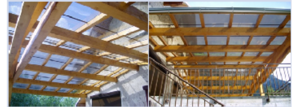
Verrière photovoltaïque à modules semi-transparents au silicium en couche-mince
