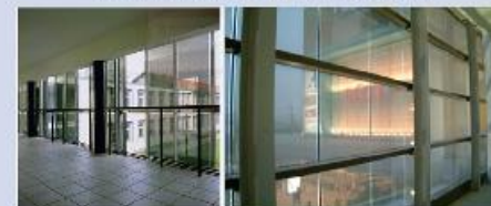
Murs-rideaux en modules au silicium en couche-mince
