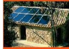
CESI monobloc posé sur toiture (haut), en « thermosiphon » au sol (milieu) et à éléments séparés intégré en toiture (bas)
