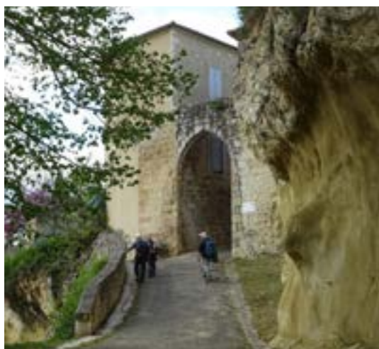
La porte de l'hérisson, érosion de l'éperon rocheux
