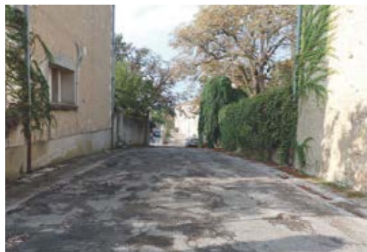
La rue Pasteur, une chaussée endommagée
